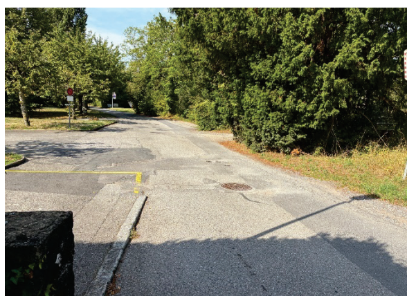
Ch. Vallon n° 116 – état actuel de la chaussée
