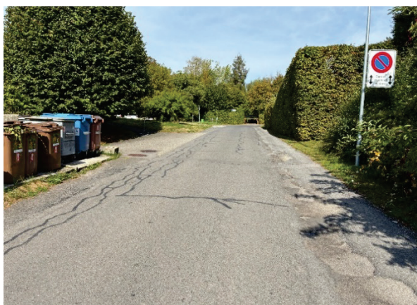
Ch. Vallon n° 53 à 61 – état actuel de la chaussée
