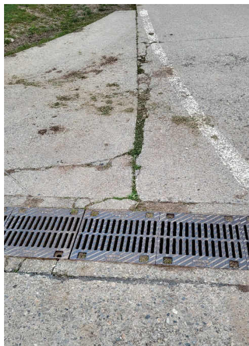
Revêtement actuel – Exemple de dégradations ponctuelles
