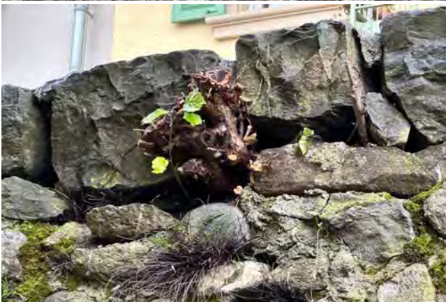
Racine de lierre engagée profondément dans la maçonnerie causant d'importantes altérations du parement.
